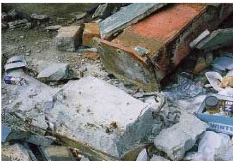
柱脚 アンカーボルトの破断
