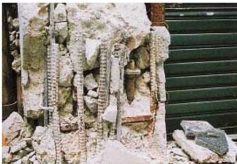
柱脚 根巻きコンクリートの破壊
