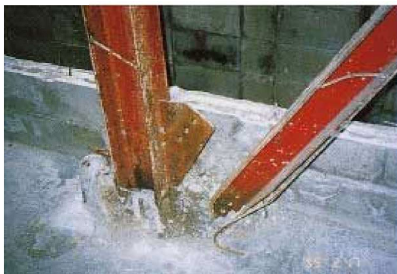
筋交い 端部ボルトの破断
