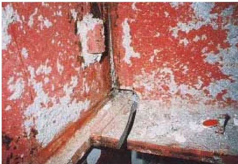
箱形柱・H形梁仕口 下端フランジ全面降伏後の 脆性破断
