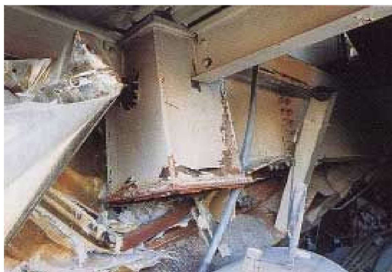
箱形柱・H形梁仕口 柱頭部仕口隅肉溶接の破断
