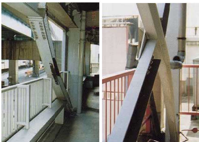
筋交い H形鋼・溝形鋼筋交の座屈
