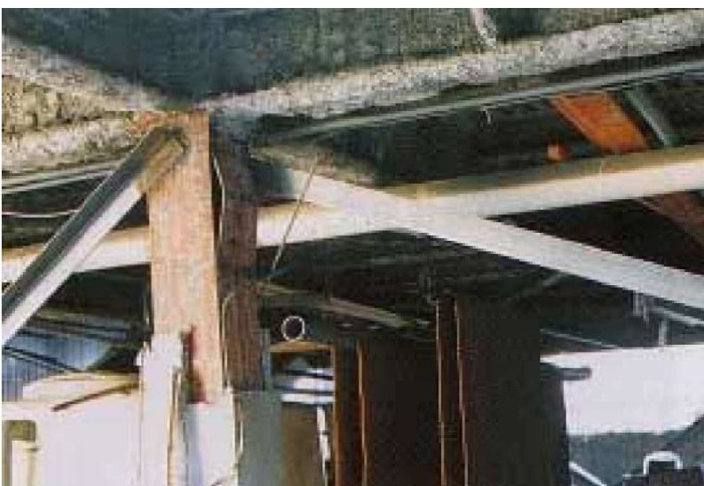
日の字形柱・H形梁 カバープレートの破断による 柱頭部局部座屈
