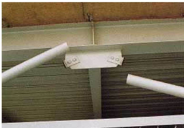
筋交い 鋼管筋交の端部破断
