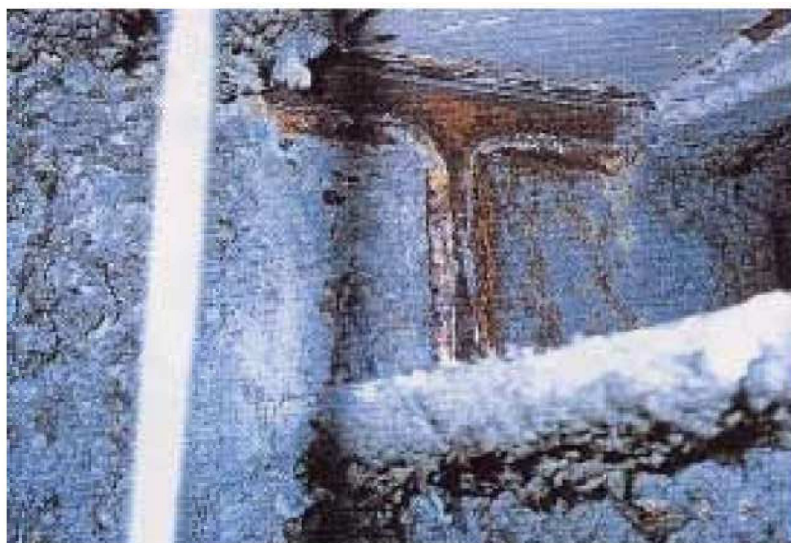
日の字形柱・H形梁仕口 梁端隅肉溶接部の破断
